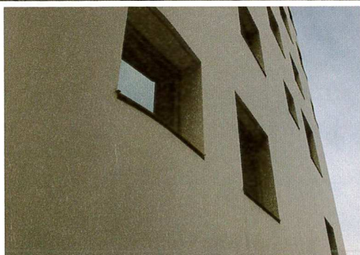
写真1 ひび割れリスクがある建築物に導入
