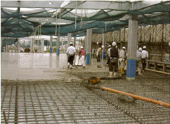
写真3 床スラブの施工は特に注意 床スラブはひび割れ誘発目を施工できないため、ひび割れが生じやすい。膨張材を使うときにも、十分な配慮が必要だ (写真：下も鹿島)
