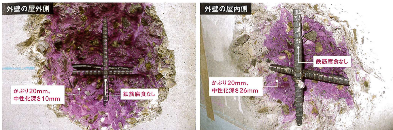
写真2 中性化が進んでも屋内側の鉄筋は腐食しにくい
