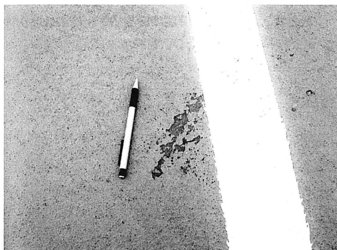
⑩ トップコートの摩耗（FRP防水）
