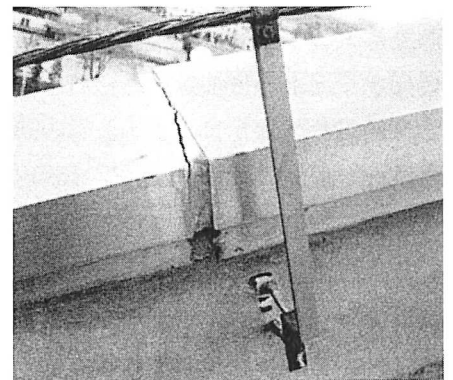
⑤ジョイントシール切れ
