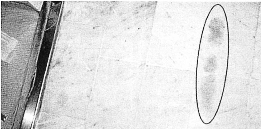
②洗面室の床石に発生した染み・変色
