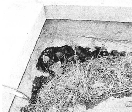
⑦ルーフトレン・樋の堆積物
