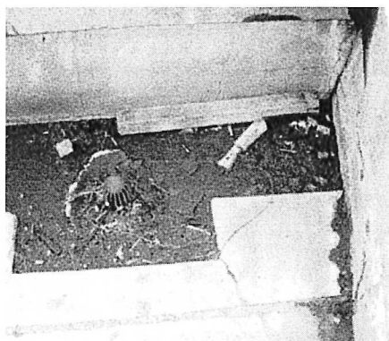
⑧ルーフトレン・樋の堆積物
