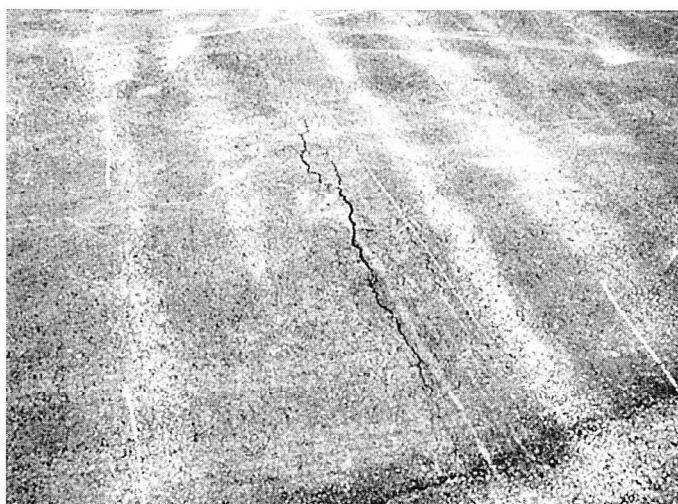
⑬ 作業車両による防水層の損傷
