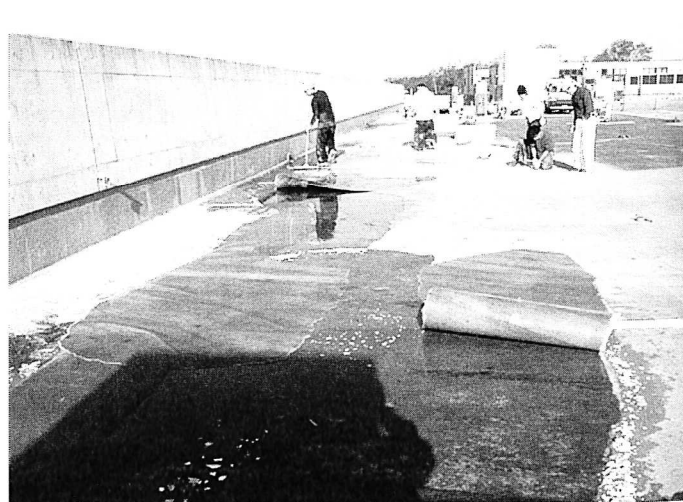
⑨スラブとの接着不良 (FRP防水)
