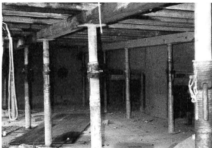
③プール底部のうちプールサイド直下は天地の高さが低く防水層の施工性がよくない
