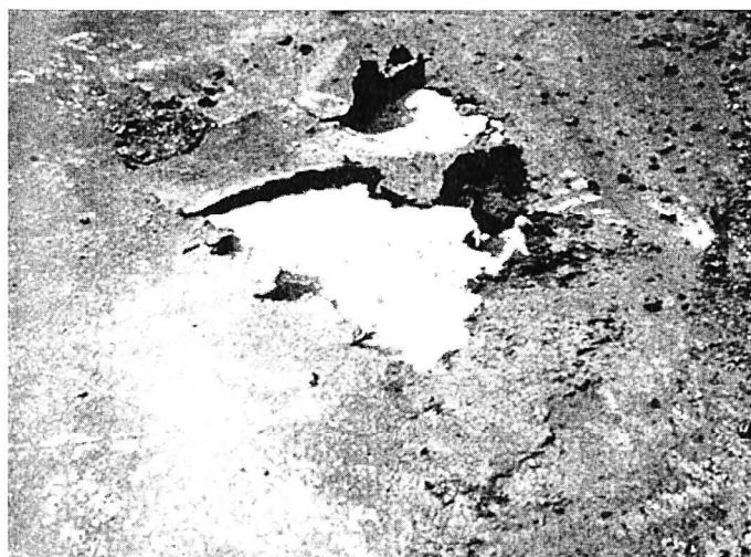
⑫ アスコンのひび割れとふくれ
