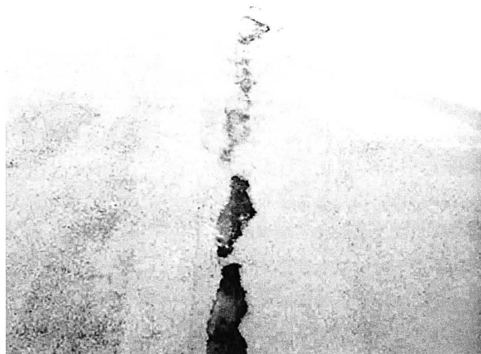
⑦スラブひび割れによる破断 (ウレタン防水)
