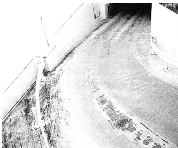
⑥スロープの摩耗 (ウレタン防水)
